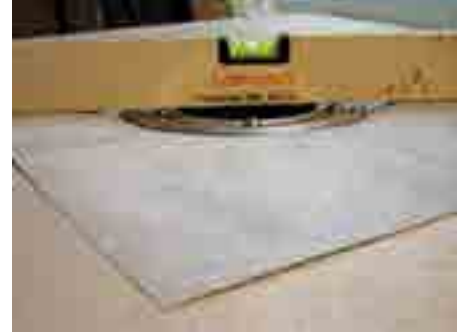
6. İzolasyon takımı şap seviyesinin altında kalıyor
